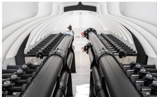
Abb. 2 Innenansicht eines Verteilerschachts der GN X4 - Serie.
