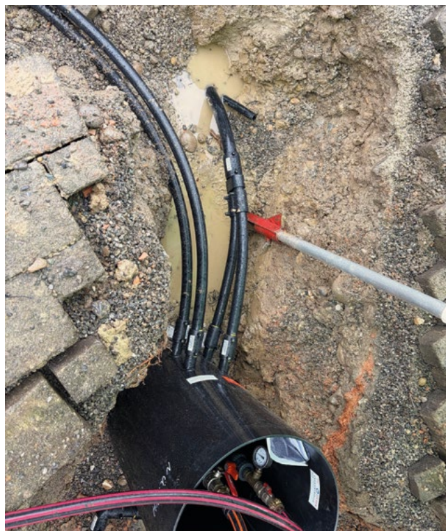
Abb. 6 Eine Verteileranlage von Geser Erdwärme komplettiert das Erdwärmesystem.
