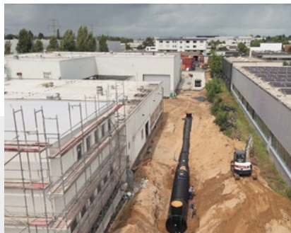
Abb. 2 Blick auf die Halle und den THERMTANK.
