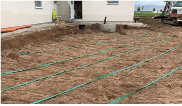
Abb. 4 Warnband, ca. 60cm über dem Kollektor, als Hinweis für spätere Gewerke.
