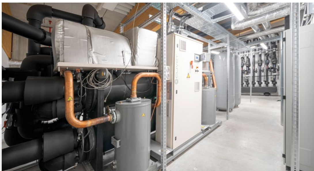
Abb. 2 Technikzentrale der Firma Hammerbacher, Bildquelle: Max Bögl/Reinhard Mederer.
