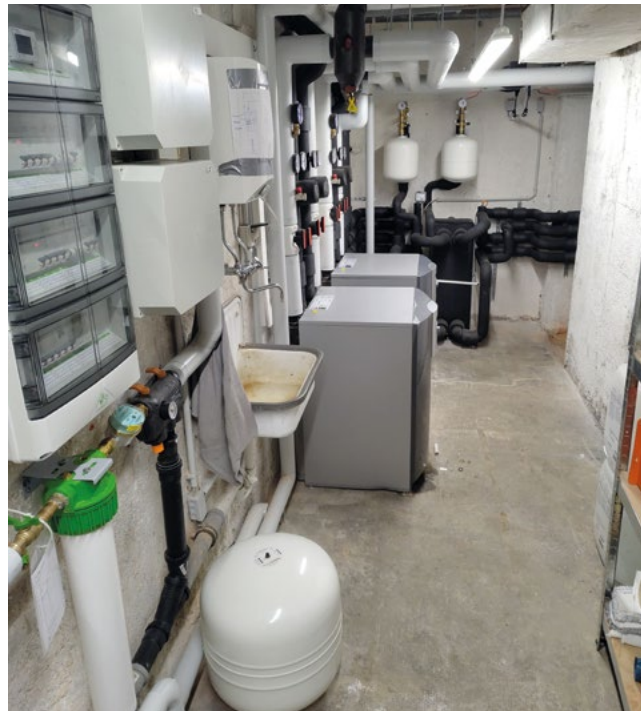
Abb. 1 Blick in den Technikraum mit den Wärmepumpen.
