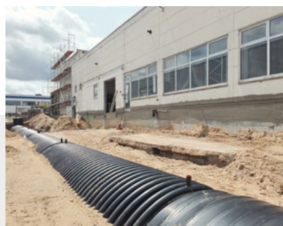
Abb. 6 Der größte Tank befindet sich im vorderen Bereich der Halle.
