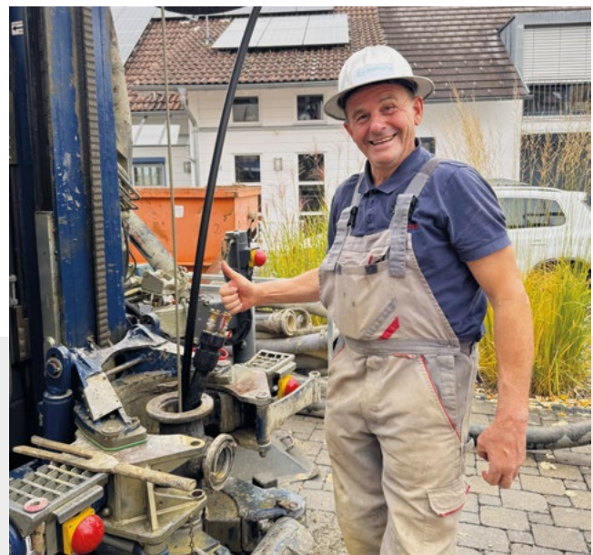
Abb. 4 Erfolgreicher Einbau der ersten separatus Sonde auf deutschem Boden.
